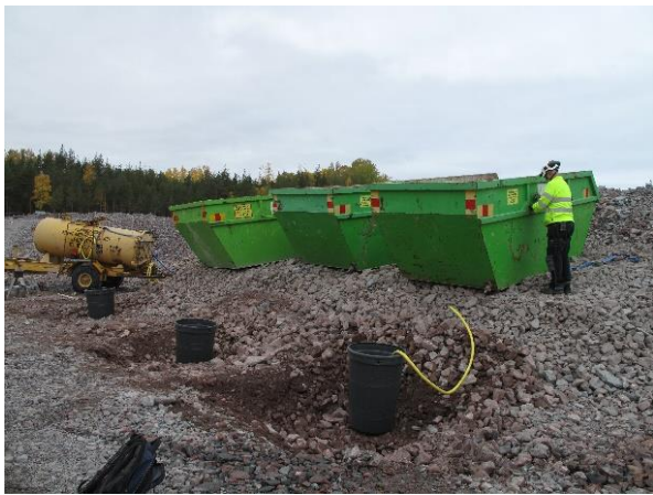
Figur 14. Tunnor för uppsamling av lakvatten
